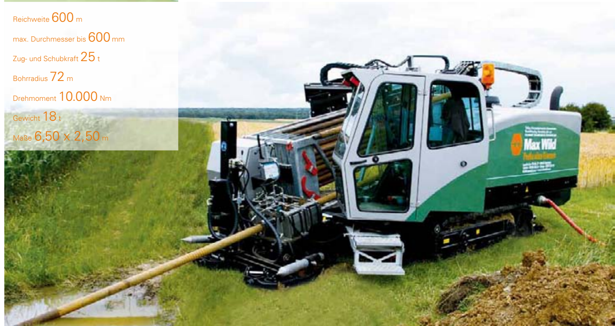
25-Tonnen-Bohrgerät mit einer Bohrlänge von 275 Metern und dem anschließenden Rohreinzug von 8 Stück DA 50 Rohren
