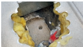
Dachaufbau aus versteckten Asbestzement-Wellplatten unter neuer Eindeckung aus Profilblech mit krebs-erzeugender Mineralfaserdämmung
