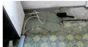
Bodenbelag mit asbesthaltiger Pappe an Unterseite
