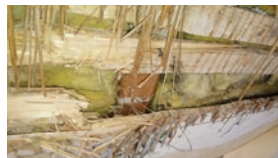
Dachinnendämmung aus krebs-erzeugenden Mineralfasermatten hinter verputzten Strohmatten
