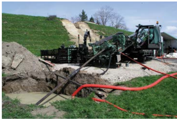
1. Bohrschlamm aus einer Horizontal- oder Vertikalbohrung
